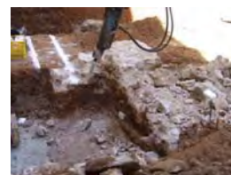
DSCF2024 Afectació mur 1027
