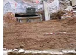
DSCF2014 Afectació estructures nivell superior
