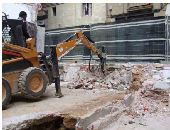
Vista general del procés d'afectació del sòcol de formigó
