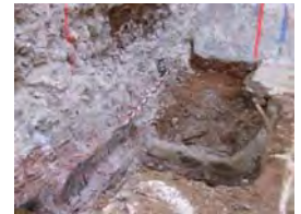
DSCF1979 Cala 3 Dipòsit fuel
