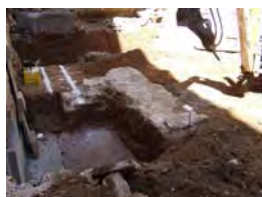
DSCF2022 Afectació mur 1027
