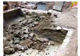
DSCF2020 Afectació estructures
