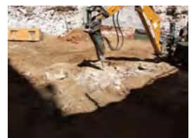
DSCF2025 Afectació Nivell Superior
