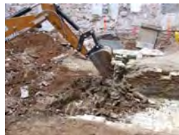
DSCF2018 Afectació estructures
