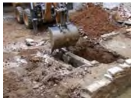
DSCF2017 Afectació estructures
